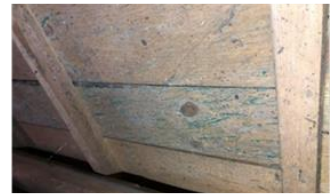
乾燥が不十分だったためカビが発生している住宅。
