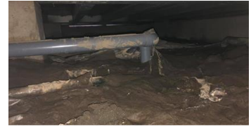
浸水した家の床下。
